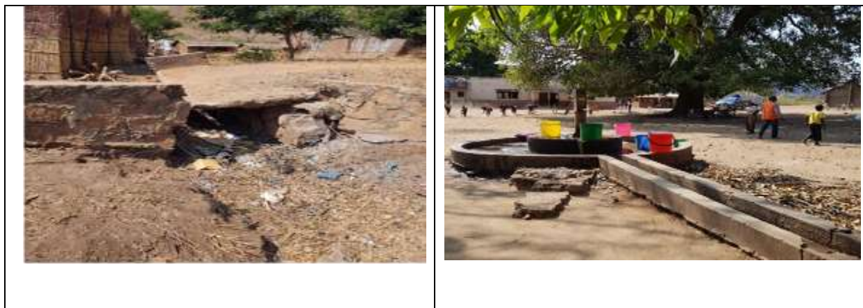
Figura 34 Destruição de infraestruturas devido a falta de drenagem de água pluvial (à esquerda). Fonte de água munida de drenagem para escoamento da água (à direita)
