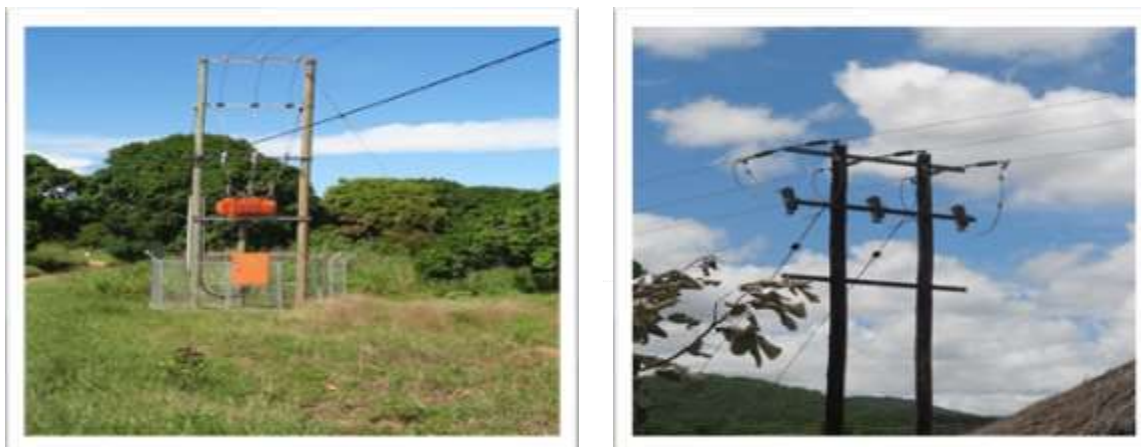
Figura 46 Vista de dois postos de transformação de energia eléctrica
