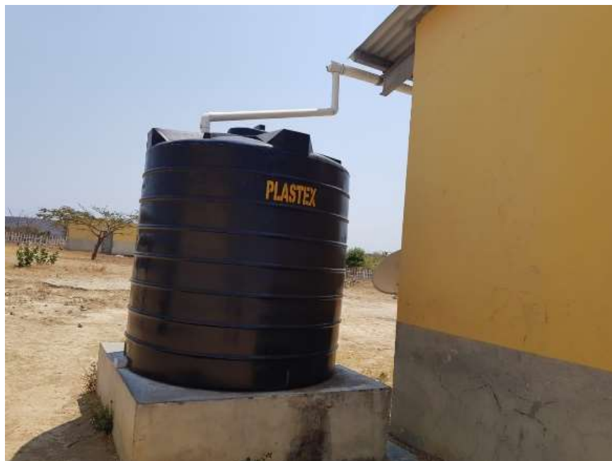
Figura 16 Reservatório de captação e armazenamento de água pluvial
