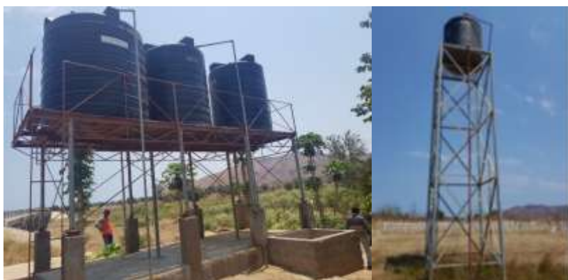
Figura 23 Depósitos elevados do PSAA na vila de Metangula
