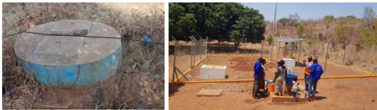
Figura 24 Poço de captação e fontanário na vila de Metangula, PSAA Micuio
