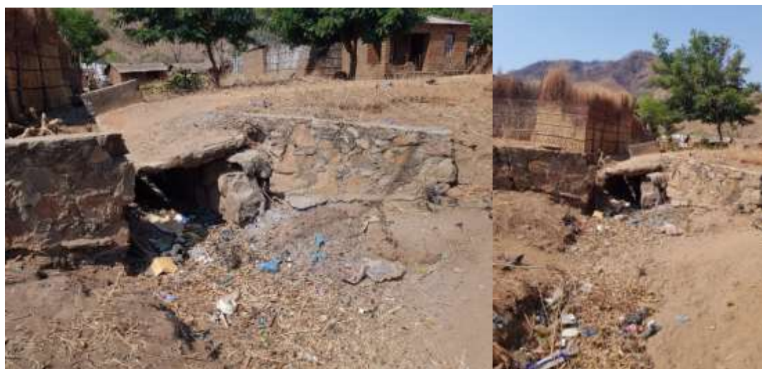
Figura 37 Erosão Hídrica no Bairro Thungo
