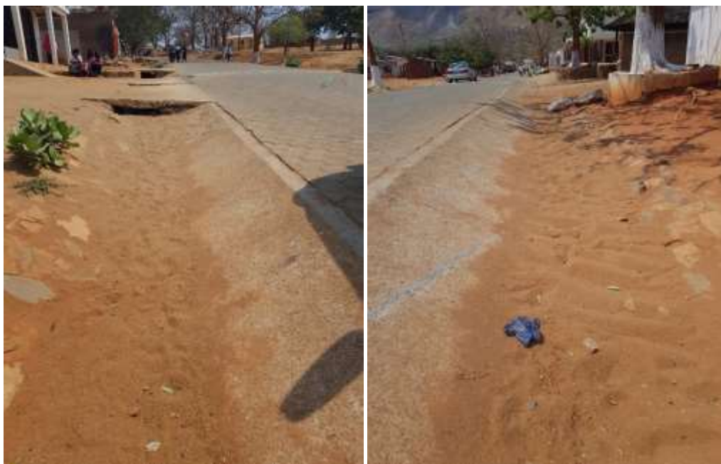
Figura 33 Vala de Drenagem assoreada
